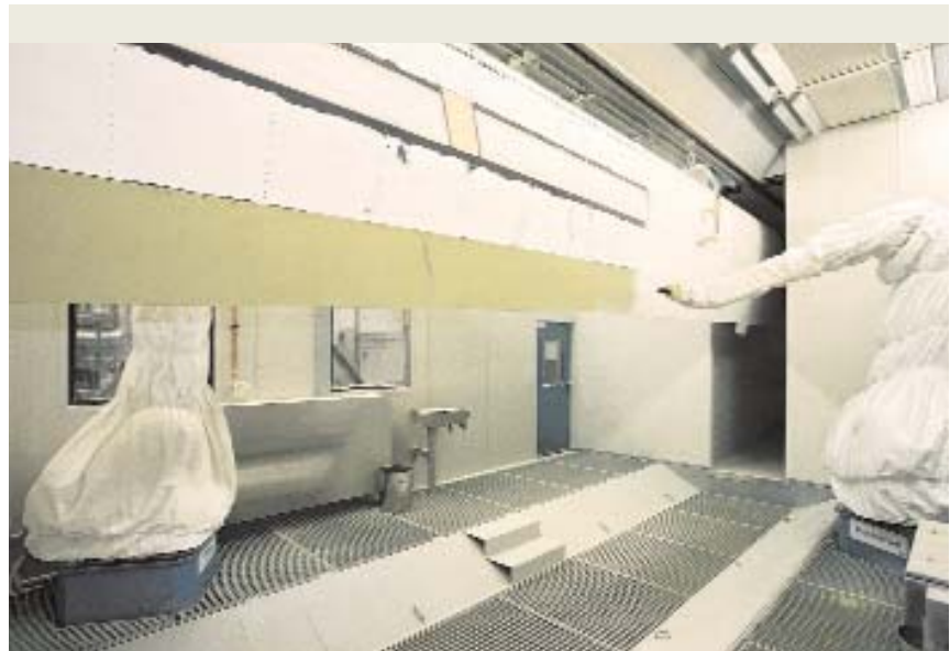
Die ehemals manuelle Beschichtung ist der vollautomatischen Lackierung in einer Umluftkabinen mit Trockenabscheidung gewichen
